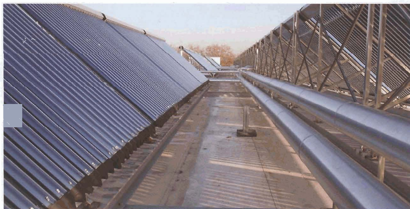
Een enorme investering: de zonnepanelen op het dak van Lavans aan de Ringdijk
